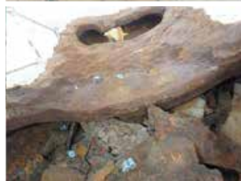
一个状况非常差的集装箱底座致使其无法正常使用
