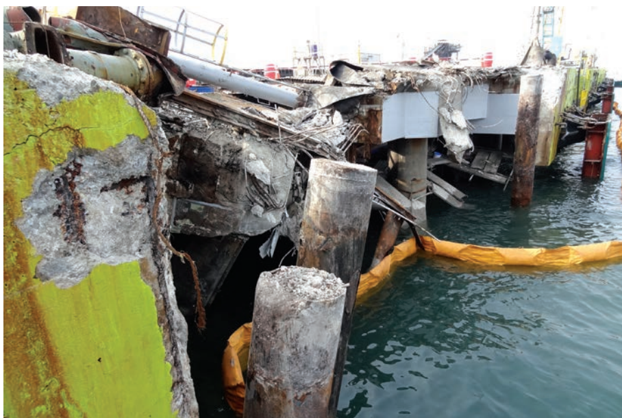
碰撞事故导致一韩国码头损坏
